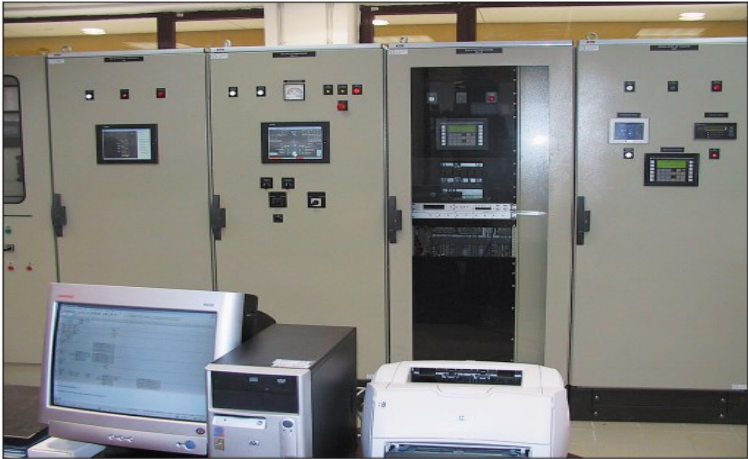
Camera de comanda si dulapurile de control servicii generale centrala, de control, protectie si regulator de viteza hidroagregat
